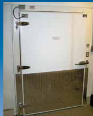
Porte de chambre froide
